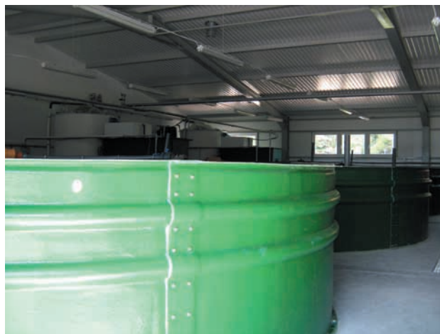
Fot. 3. Baseny rotacyjne obiegu zamkniętego do chowu selektów jesiotra ostronosgo w Doświadczalnym Ośrodku Zarybieniowym „Dgał” (obecnie Zakład Hodowli Ryb Jesiotrowatych IRS w Pieczarkach).
